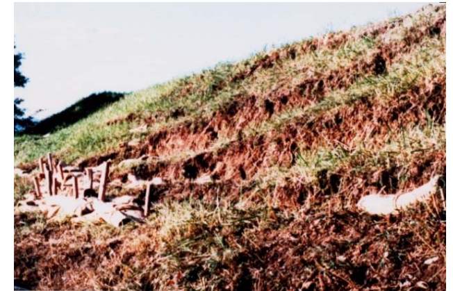
昭和57年8月洪水 魚見地区(3.8K)の堤防裏面崩落状況
