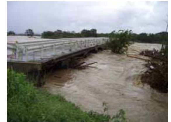
平成16年9月洪水 大平橋付近の出水状況
