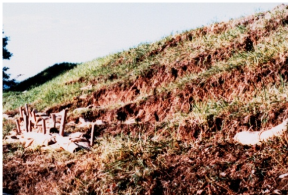
昭和57年8月洪水 魚見地区(3.8K)の堤防裏面崩落状況
