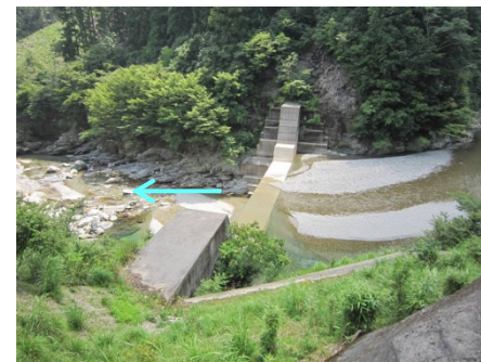
青田貯砂ダム（堆砂後） H24.7.27撮影
