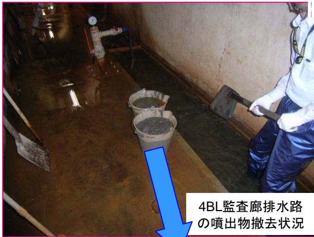
4BL 監査廊漏水と噴出物
