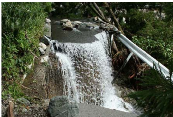
横山ダム湖岸道路の被災状況
