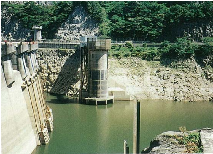
選択取水設備
