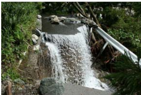
横山ダム湖岸道路の被災状況
