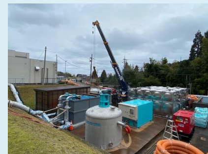
可搬式浄水施設・整備(珠洲市)
