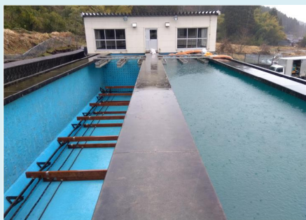
浄水場の被害(珠洲市)
