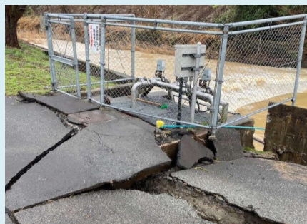
取水口の被害(珠洲市)
