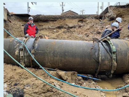
送水管の被害(七尾市)
