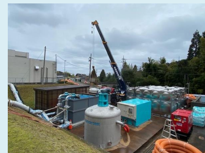
可搬式浄水施設・整備(珠洲市)
