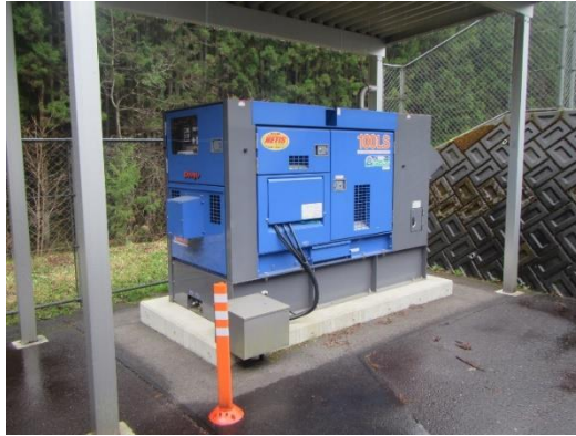
写真-15 非常用発電設備（八百津町）
