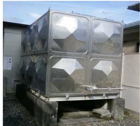
写真-22 給水栓付受水槽（静岡市）
