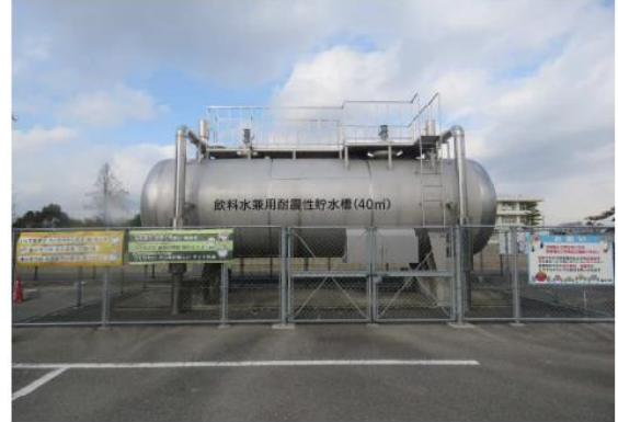
写真-5 耐震性貯水槽（輪之内町）
