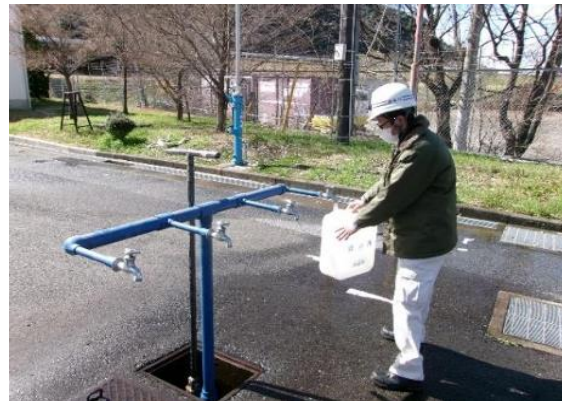
写真-7 仮設給水栓（岐阜市）
