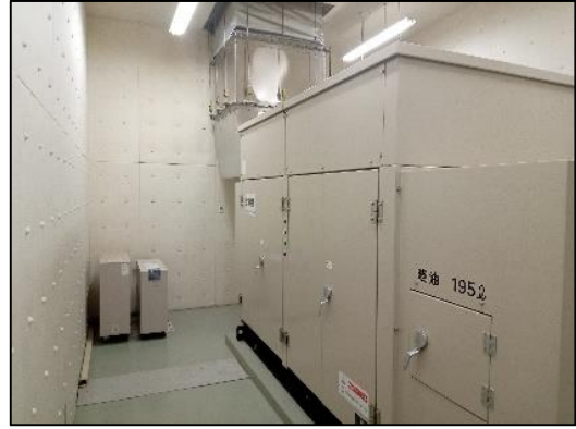
写真-16 非常用発電設備（養老町）
