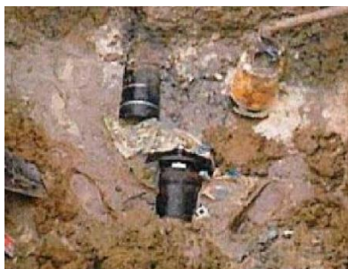
写真-1 配水管被害状況
