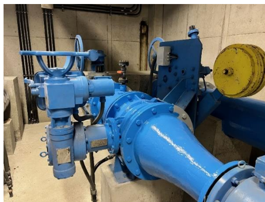
写真-17 緊急遮断弁（御嵩町）
