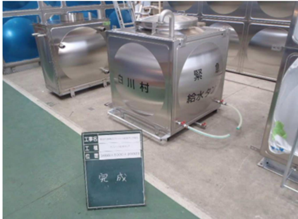
【非常用給水タンク】
