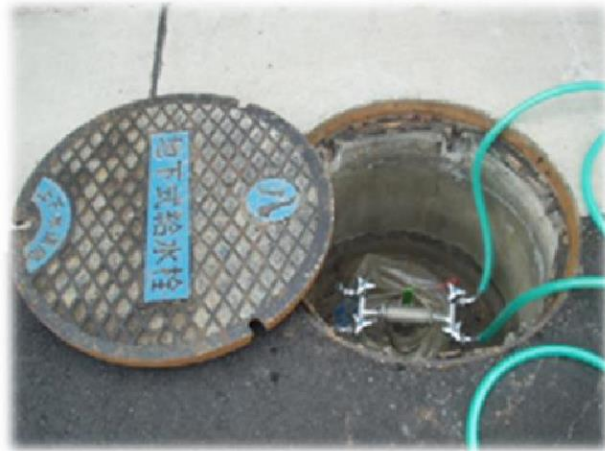
地下式給水栓
