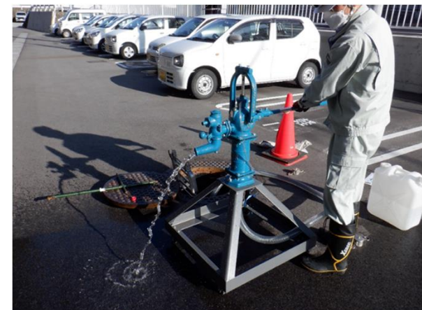
耐震性貯水槽から手押しポンプへ
