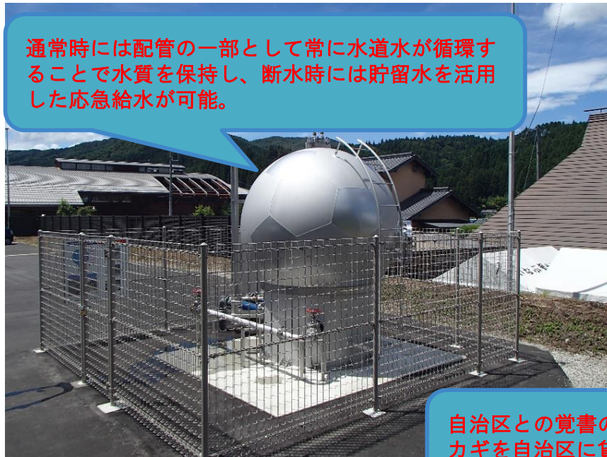
① 応急給水を行うための施設の整備例 ＜飲料用循環式耐震性貯水槽＞
