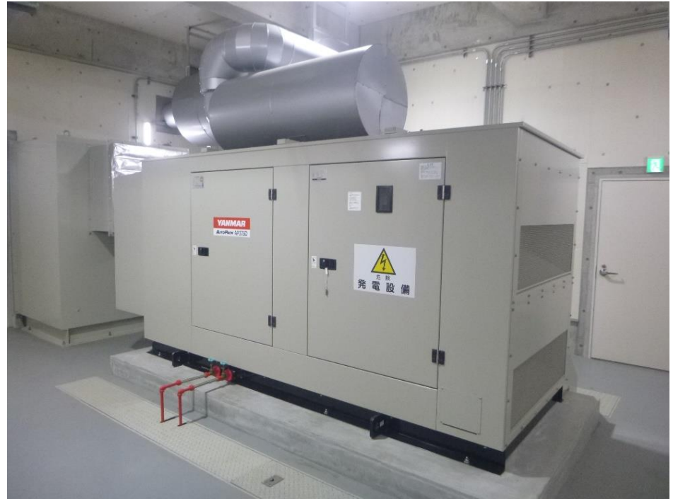
○非常用自家発電設備
