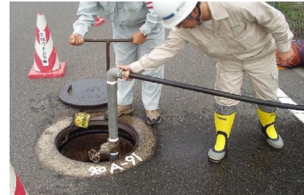
② 応急給水支援設備
