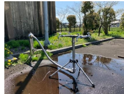
応急給水栓(消火栓接続式)
