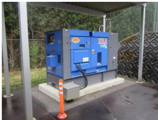
写真- 1 2 非常用発電設備（八百津町）
