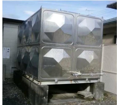
写真- 1 8 給水栓付受水槽（静岡市）
