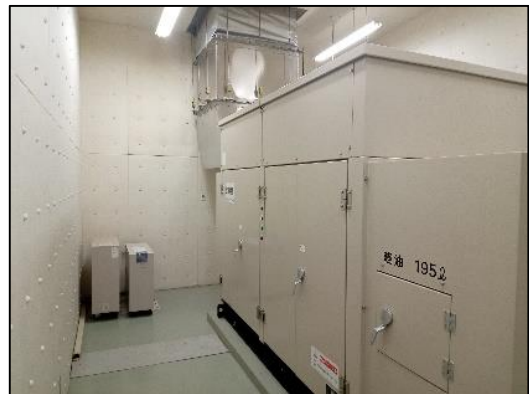
写真- 1 3 非常用発電設備（養老町）
