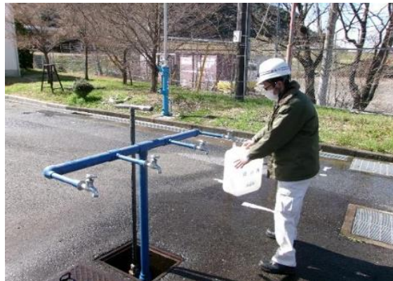
写真- 4 仮設給水栓（岐阜市）
