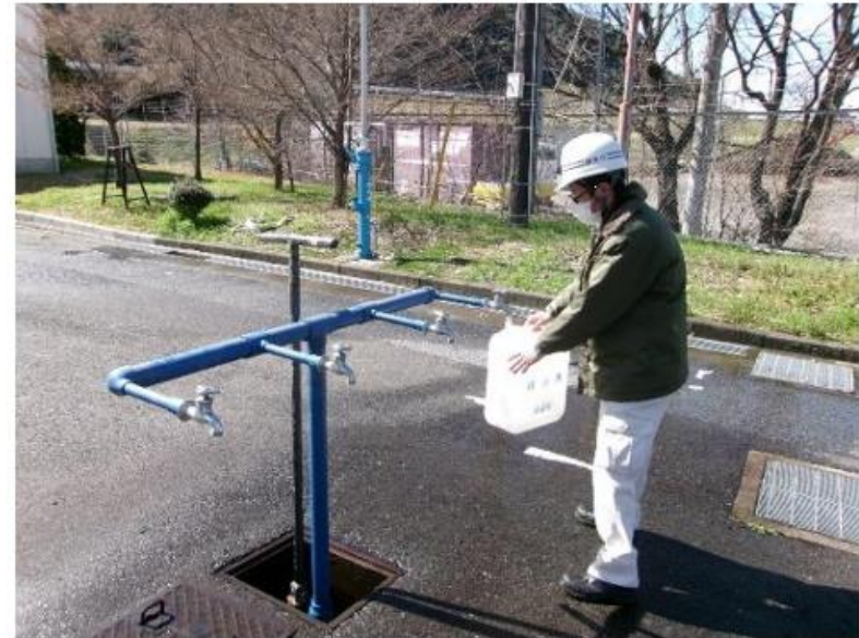
【写真-2 消火栓設置型仮設給水栓】
