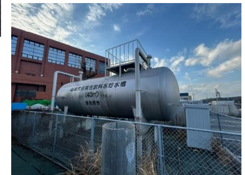
地上式耐震性貯水槽
