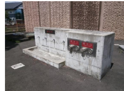
緊急給水設備
