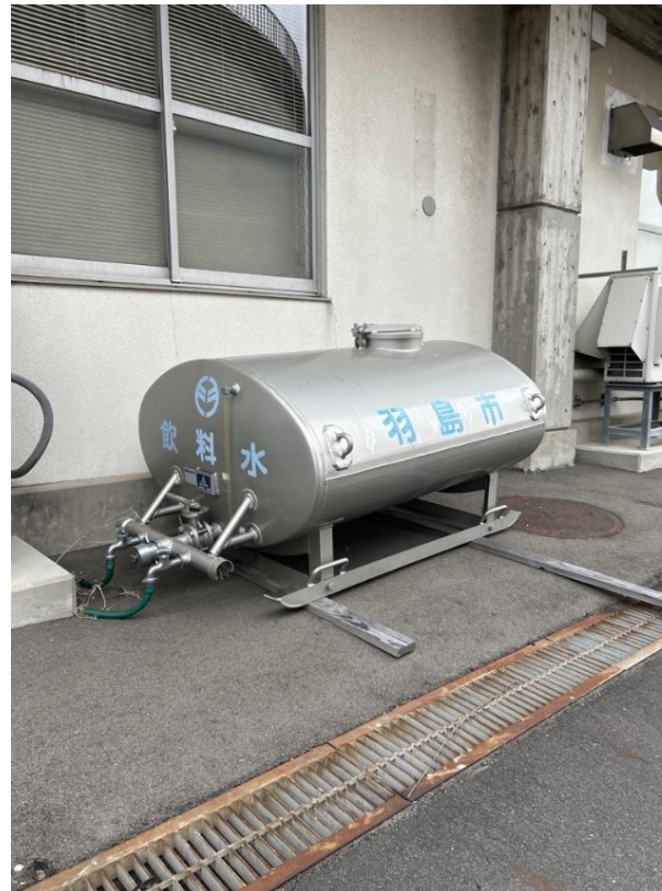
給水タンク(1000ℓ) ※トラックに搭載可能
