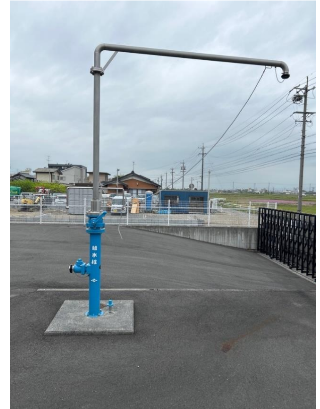
給水車専用給水栓
