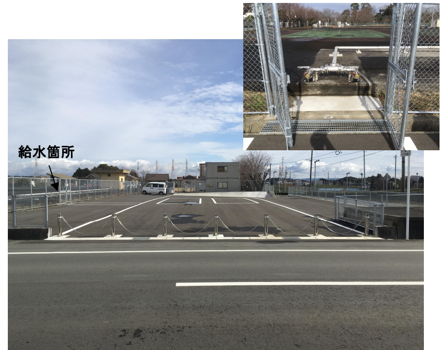
訓練を踏まえ整備された応急給水施設
