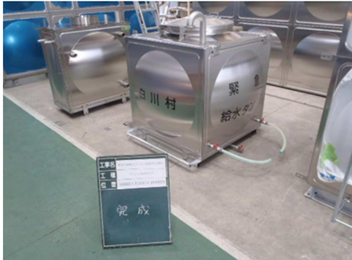
【非常用給水タンク】
