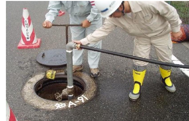
② 応急給水支援設備
