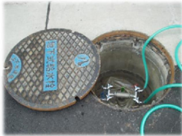
地下式給水栓
