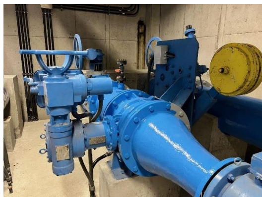
写真- 1 4 緊急遮断弁（御嵩町）
