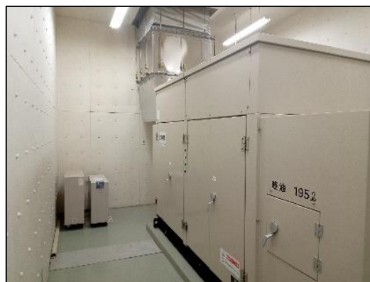
写真- 1 3 非常用発電設備（養老町）
