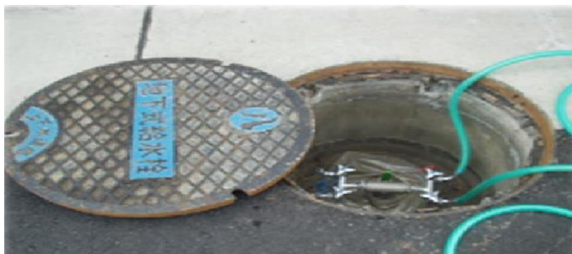
写真- 5 地下式給水栓（名古屋市）
