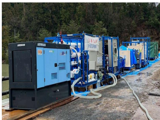
写真- 8 大型可搬型浄水装置
