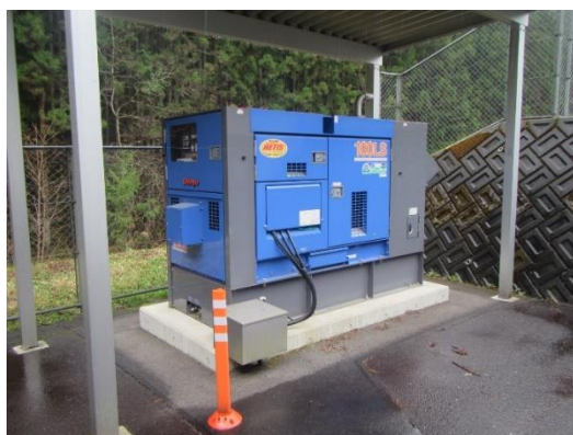
写真- 1 2 非常用発電設備（八百津町）
