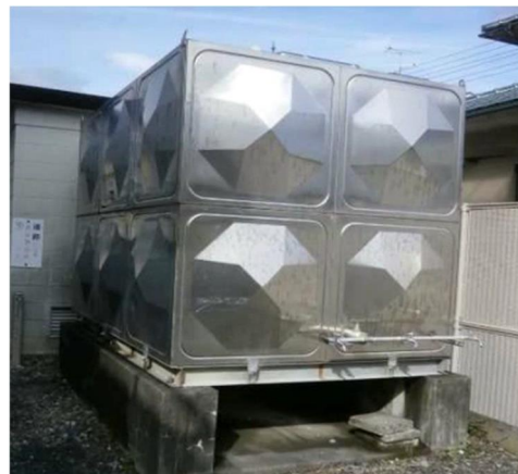
写真- 1 8 給水栓付受水槽（静岡市）
