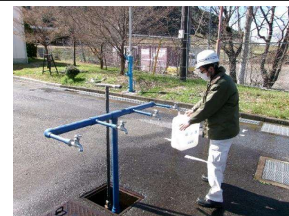
【写真-2 消火栓設置型仮設給水栓】
