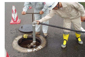
2 応急給水支援設備 臨時に県企業庁空気弁から直 接給水(避難所等350か所)
