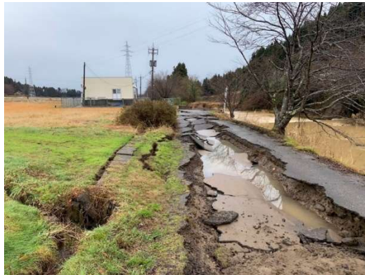
導水管の布設道路の崩壊
