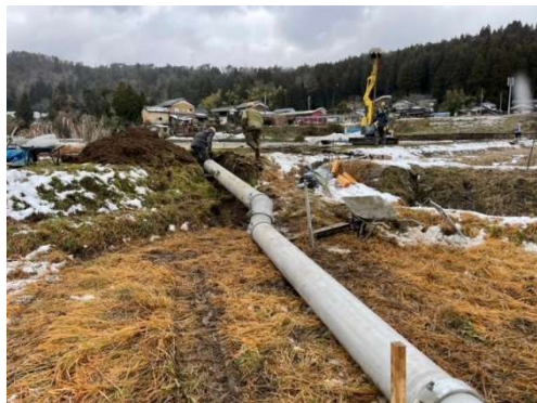
導水管の仮設管
