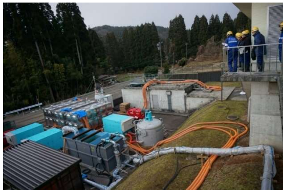
宝立浄水場内の可搬型浄水装置の設置
