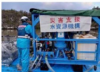
設置された浄水装置 (1月9日から給水開始)
