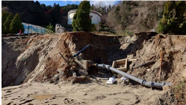
岩屋浄水場の土砂崩壊
