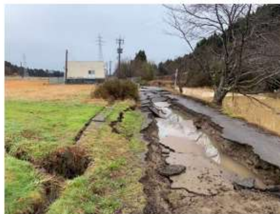
【被害状況】珠洲市宝立浄水場（導水管）
