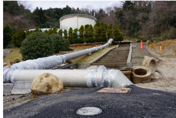
岩屋浄水場の構内配管の仮設管
