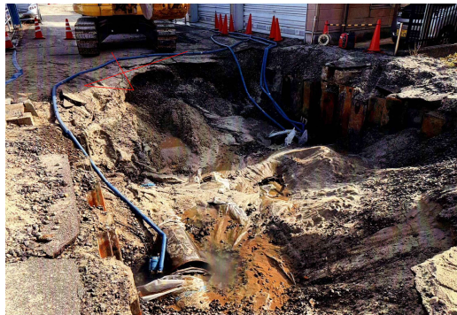
岩屋浄水場付近の主要な管路損傷
