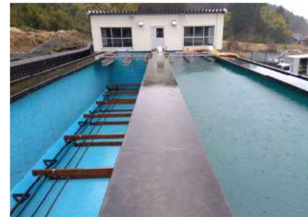
【被害状況】珠洲市宝立浄水場（沈殿池）
