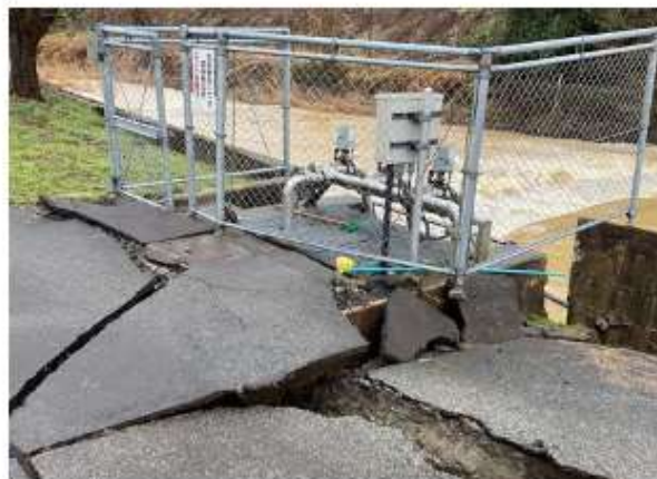
【被害状況】珠洲市宝立浄水場（取水口）
