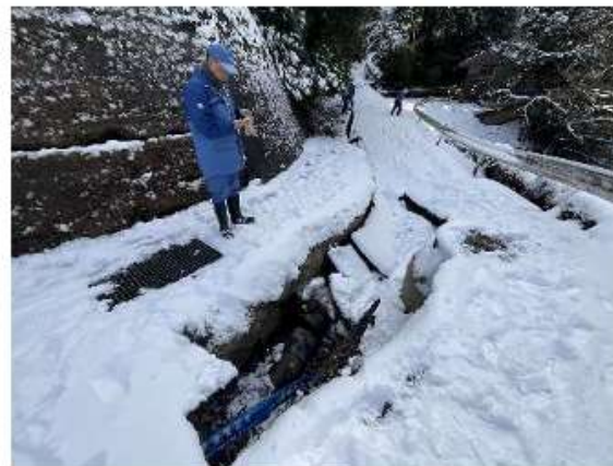
輪島市 送水管損傷
