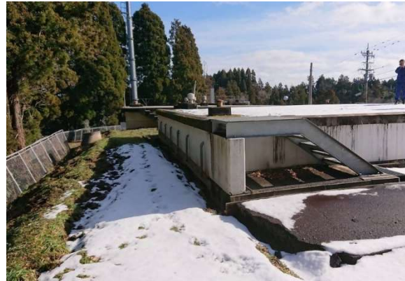
宝立配水池の地盤沈下
