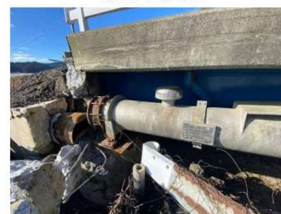
珠洲市 水管橋損傷
