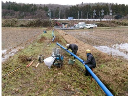
導水管の仮設管
