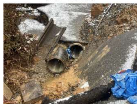
輪島市 送水管損傷
