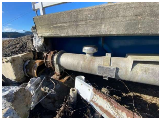
水管橋の損傷
