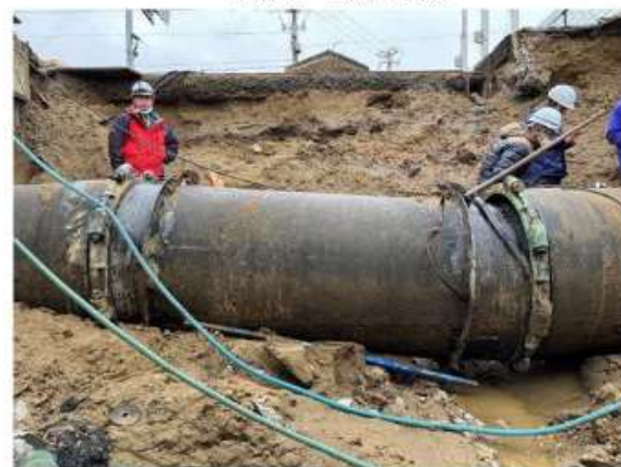
七尾市 送水管損傷
