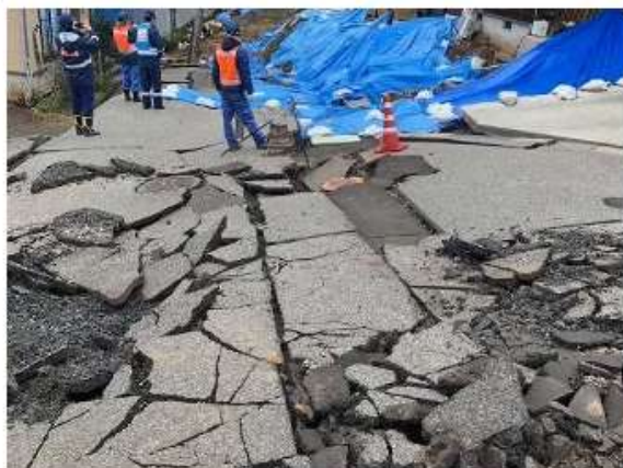
能登町 水道管損傷
