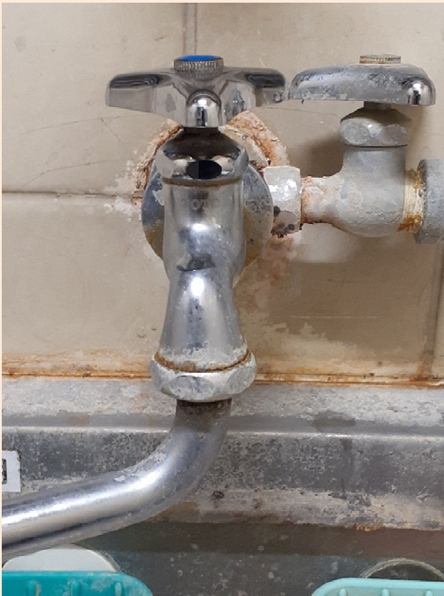
蛇口付近に付着した白い汚れ
