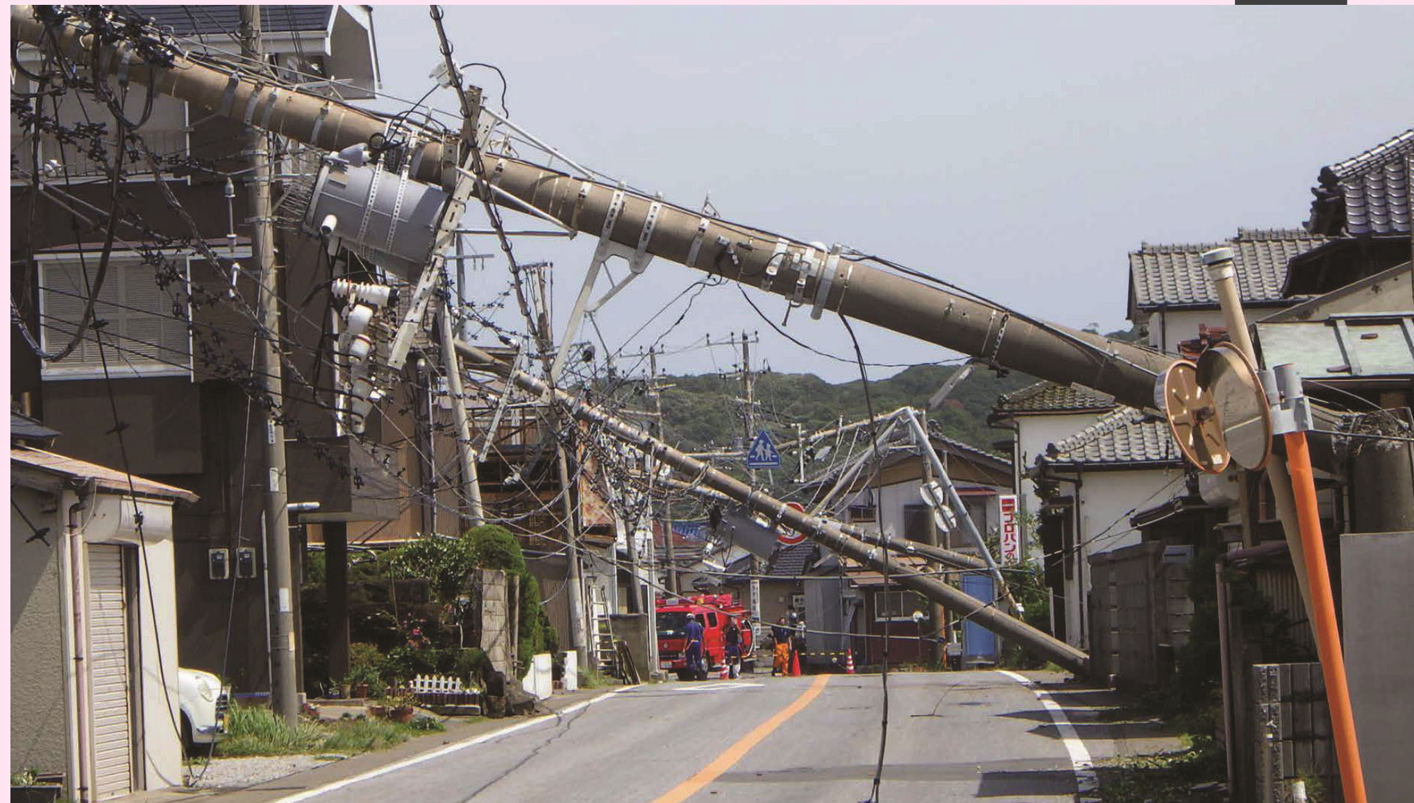
千葉県館山市 県道:館山富浦線 【令和元年9月 台風第15号】
