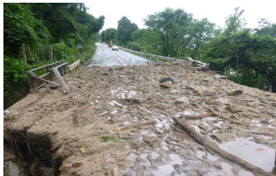
8/14被災、全面通行止め
