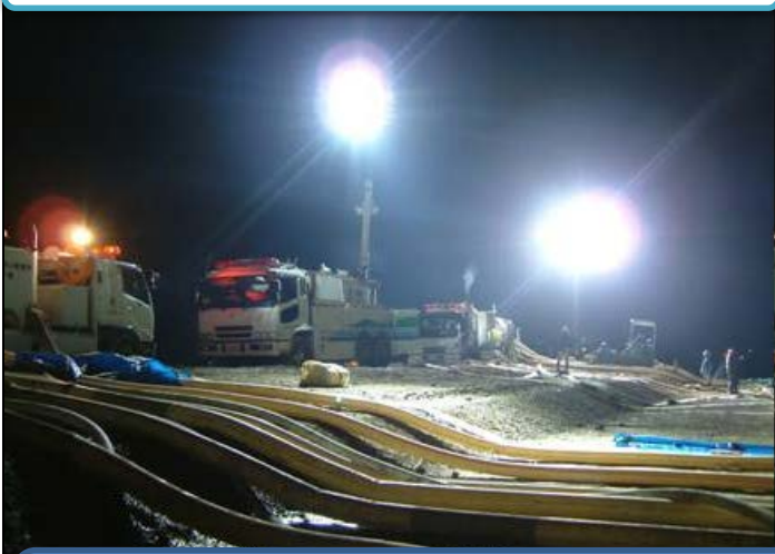
照明車と排水ポンプ車による排水作業 (天竜川上流の照明車・排水ポンプ車H23.3/14~5/9)
