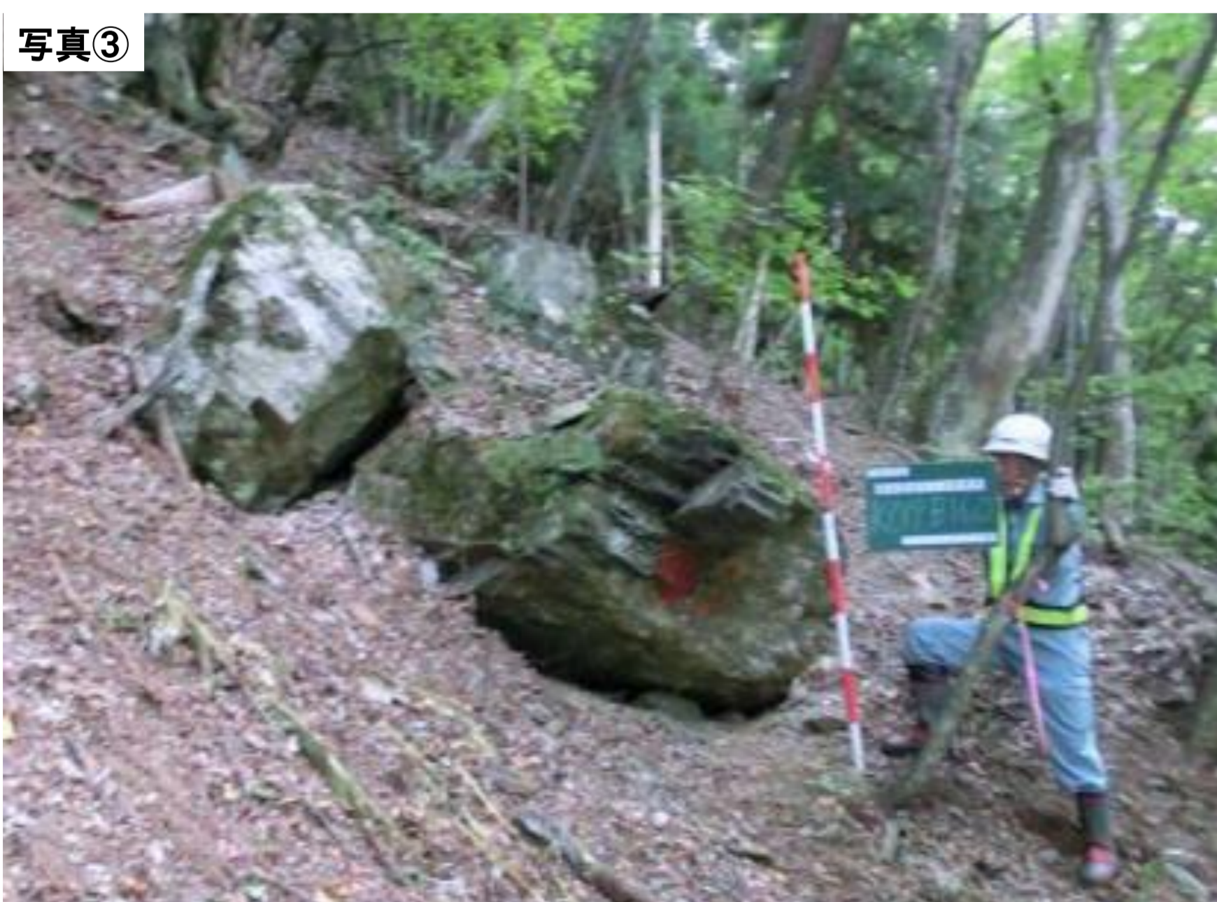
写真③ 岩石崩壊
