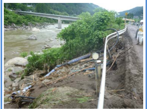
路肩の崩壊状況
