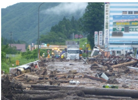
土砂流出状況(約500m)
