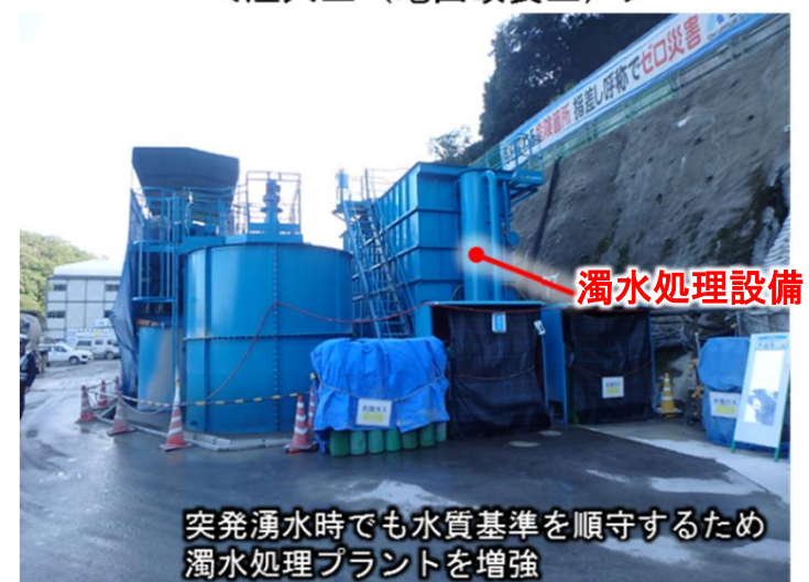
＜濁水処理設備の増強＞
