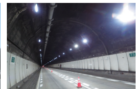
トンネル照明
