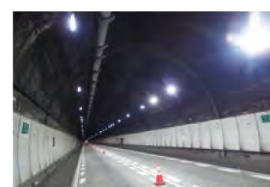
トンネル照明
