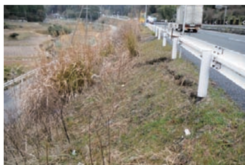
大雨後の法面亀裂
