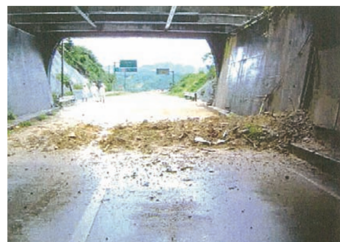
関トンネル(下り)西坑口 被害状況(トンネルの中)
