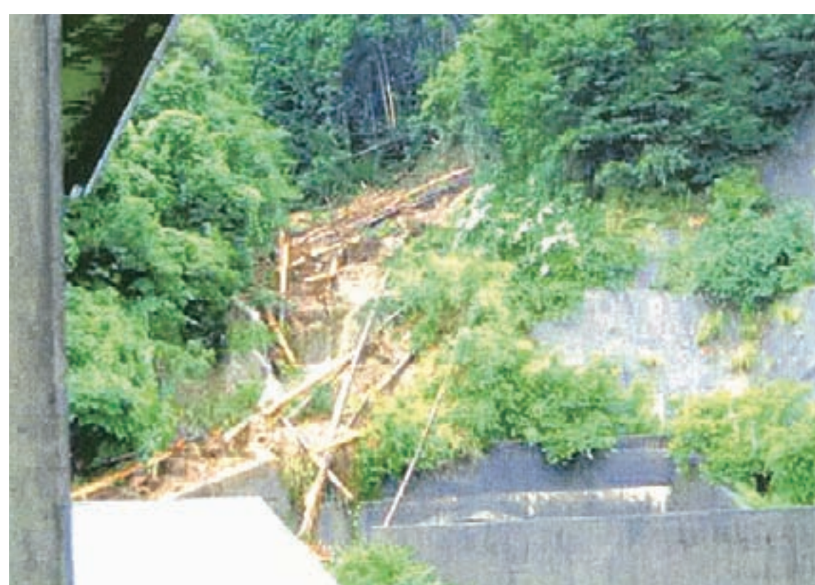
関トンネル(下り)西坑口 被害状況(トンネルのり面)
