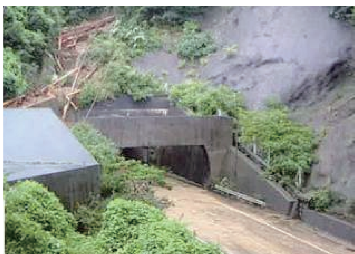
関トンネル(下り)西坑口 被害状況
