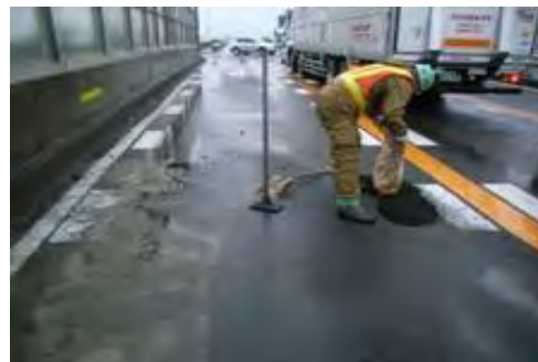
道路損傷の補修
