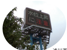
浦川西放流警報表示板
