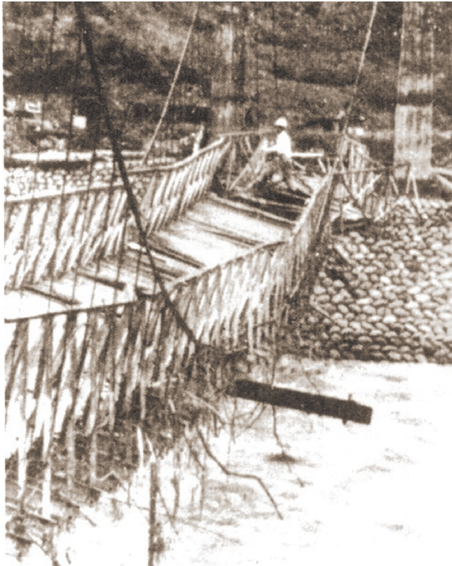
使用不能となった吊り橋(大千瀬川)
