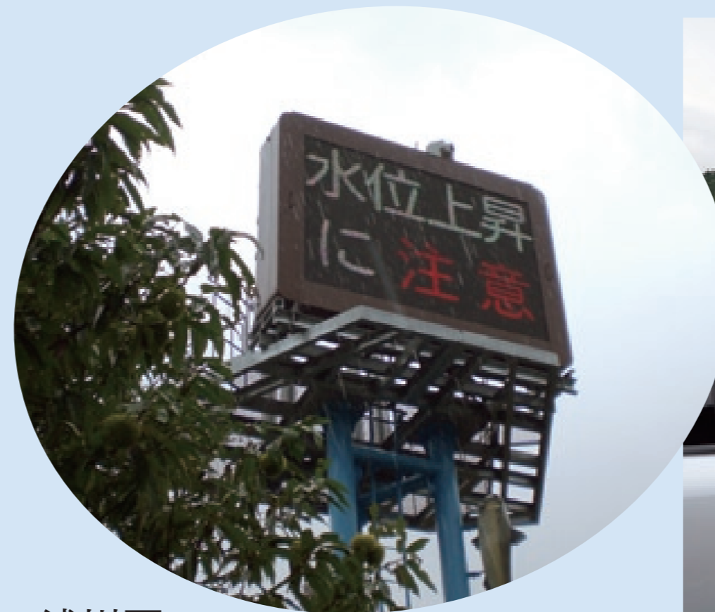
浦川西 放流警報表示板
