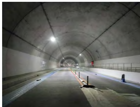
トンネル内点灯状況
