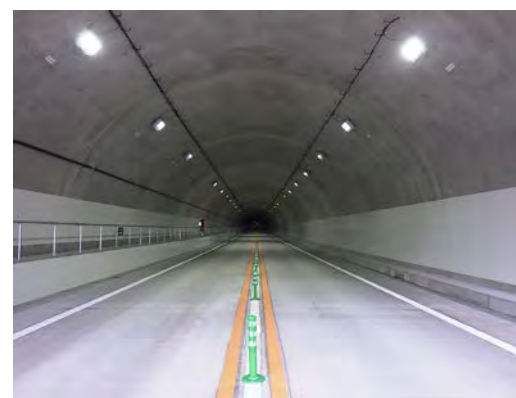
川合トンネル内照明設備
