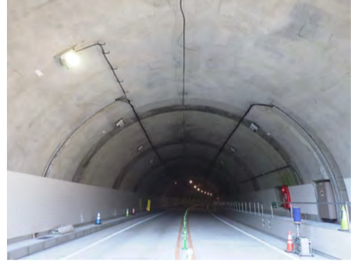
川合トンネル内照明設備
