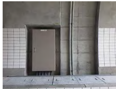
川合トンネル抗口分電盤
