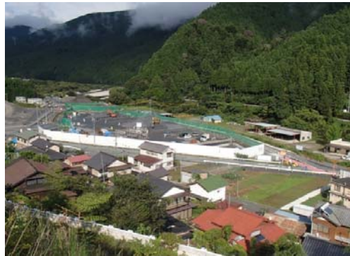
トンネルずり判定場
