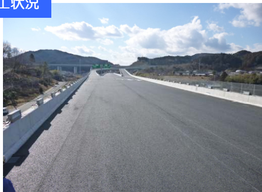
東黒田高架橋 低位置照明設置状況
