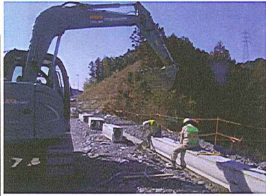
排水構造物の施工状況です。道路に降った雨をスムーズに排水します。
