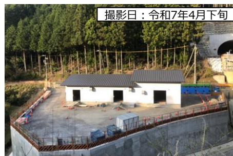
⑥ トンネル主電気室
