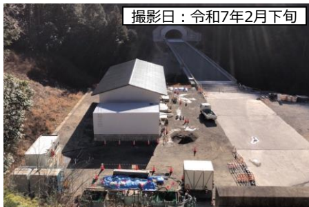
⑤トンネル副電気室
