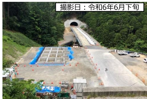
⑤トンネル副電気室
