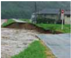
H18洪水/真輪町松島北島(天竜川右岸204.8m)破堤状況
