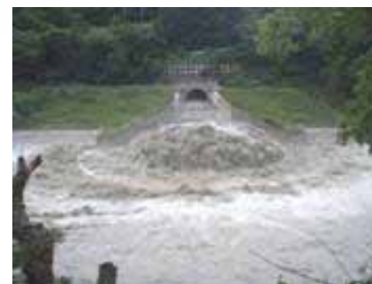
土砂バイパス出口(減勢工)
