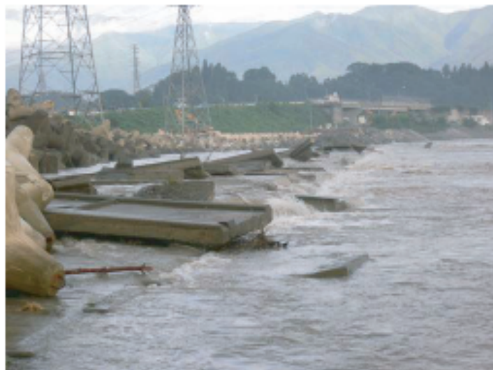
④護岸被災状況
