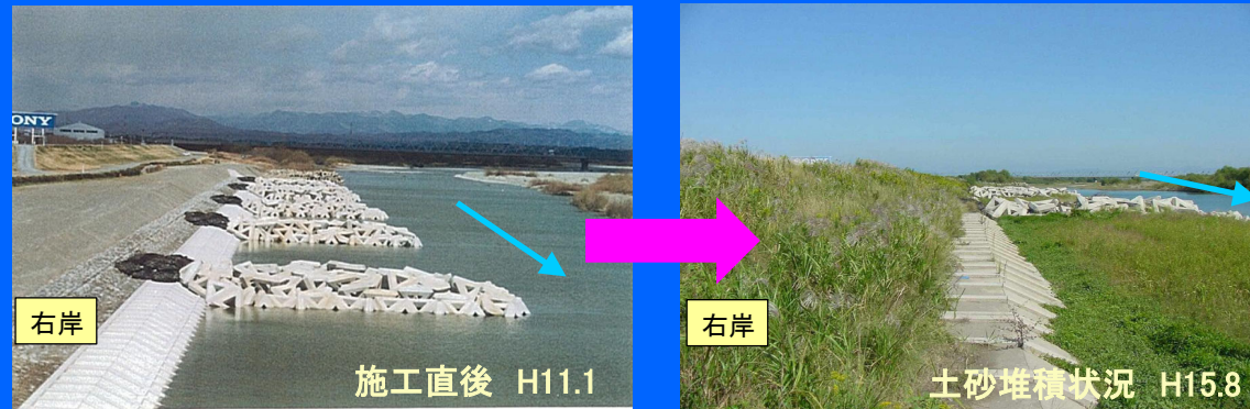
水制付近の土砂堆積状況(河口から5.0km付近右岸)
