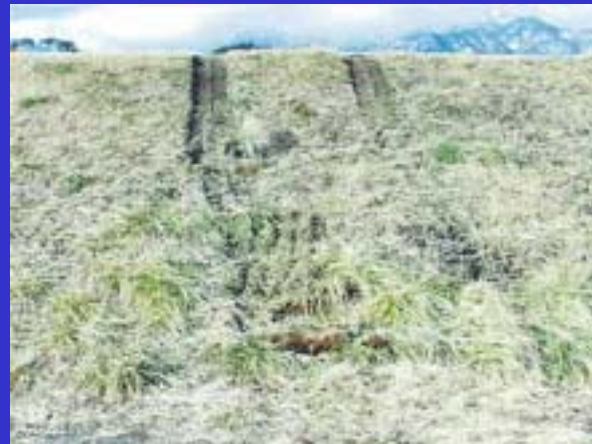
車輛による堤防の損傷 (駒ヶ根市・平成15年)
