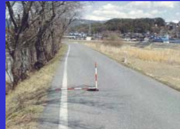
堤防道路の陥没 (伊那市・平成15年)
