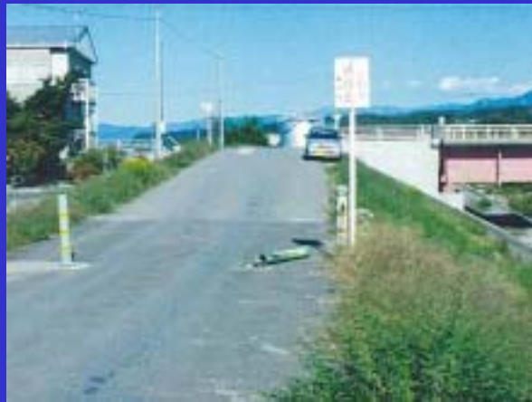
大型車通行規制のポールの損傷 (伊那市・平成14年)
