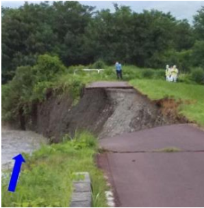
令和2年 三峰川 堤防欠損
