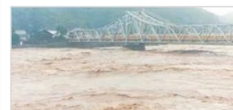
S57.8洪水: 浜松市鹿島橋付近
