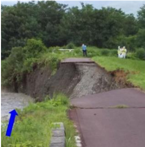
令和2年 三峰川 堤防欠損
