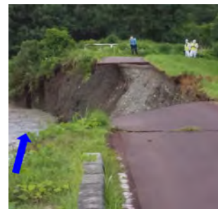
伊那市 三峰川右岸4.6k付近 堤防の欠損
