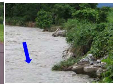
豊丘村 壬生沢川合流点上流151.4k付近 護岸一部流出
