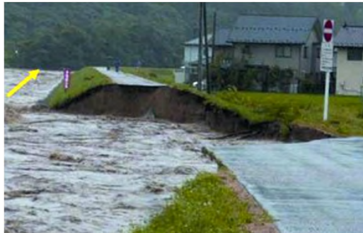
204.8kの堤防決壊状況
