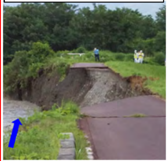
三峰川右岸4.6k付近堤防の欠損
