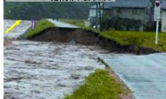
204.8kの堤防決壊状況
