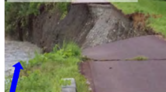
三峰川右岸4.6k堤防の欠損 R2.7
