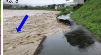
天竜川左岸208.2k河岸侵食 R3.8
