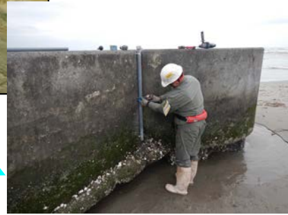
導流堤先端水位計
