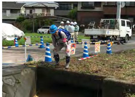
防災エキスパート 被災状況の確認
