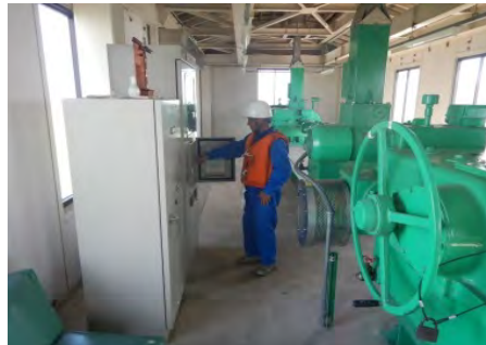
岐阜県 排水樋門の操作
